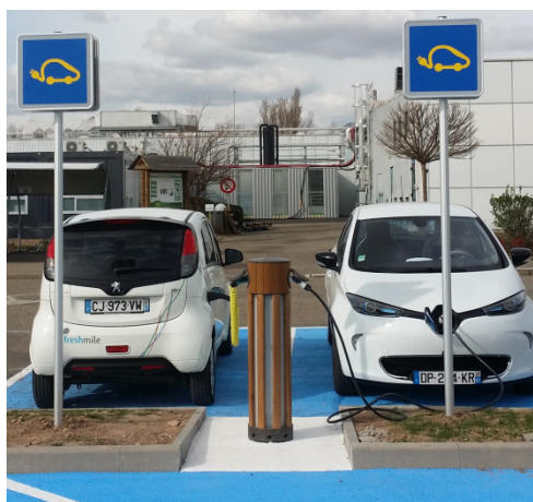
Exemple de station de charge en parking d'entreprise
